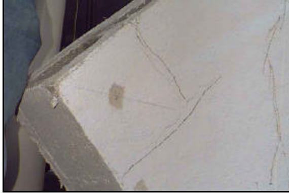
Figura 6.10 - Ruptura parede P07.
