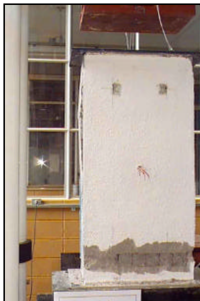
Figura 5.23 - Abaulamento do núcleo destacando-se do revestimento.
