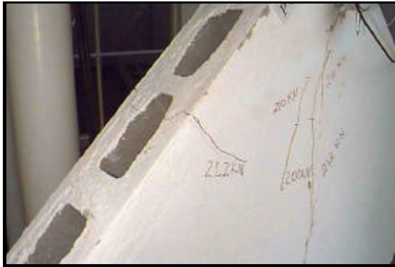
Figura 6.13 - Fissuras horizontais na parede P09.
